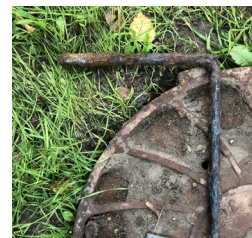
КОРРОЗИЯ ХОДОВОЙ СКОБЫ
